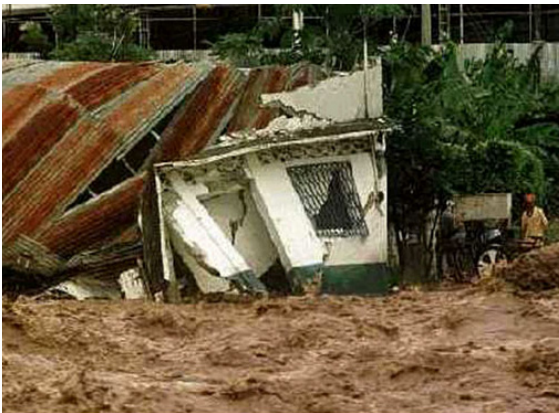
Figura 1.9 Daños ocasionados por Paulina.
