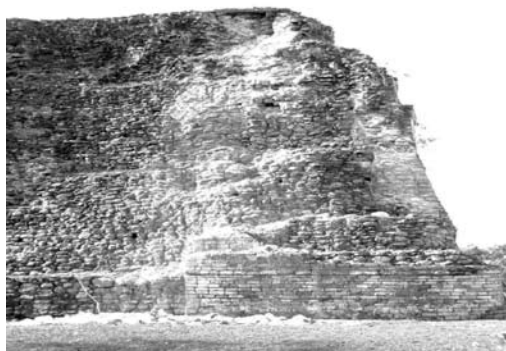
Figura 6. Daños en estructuras de la Z.A. Becán, Campeche. © Archivo Centro INAH Campeche. Diana Arano.
